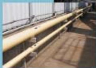
天然ガスを供給するパイプライン
