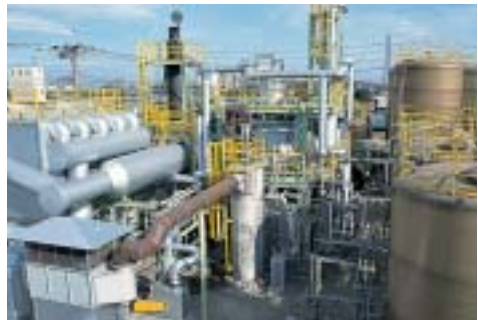
MCRプラント ：産業廃棄物の海洋投入禁止に対応した日本初の大規模陸上処理施設。フィルム・写真廃液等を高温酸化処理し、無害化します。
